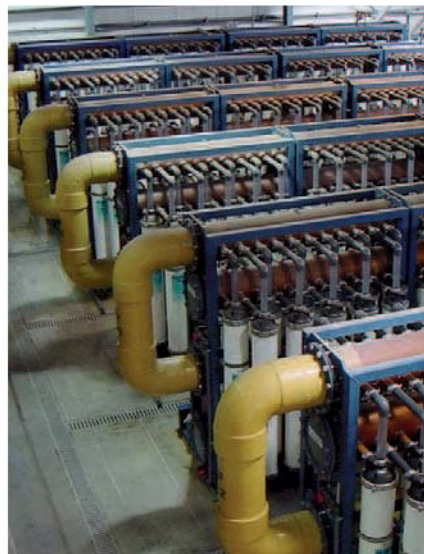
Módulos de ultrafiltración
